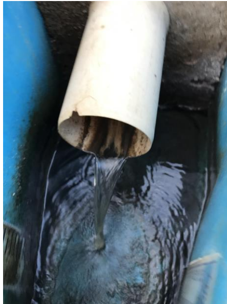
Figura 2. Efluente do Sistema de Tratamento de Águas Residuárias.
